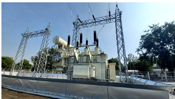
หม้อแปลงไฟฟ้า 115 - 23.1 kV
