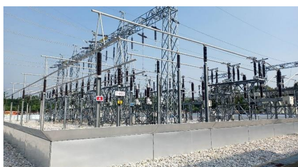
ลานไกไฟฟ้า 115 kV
