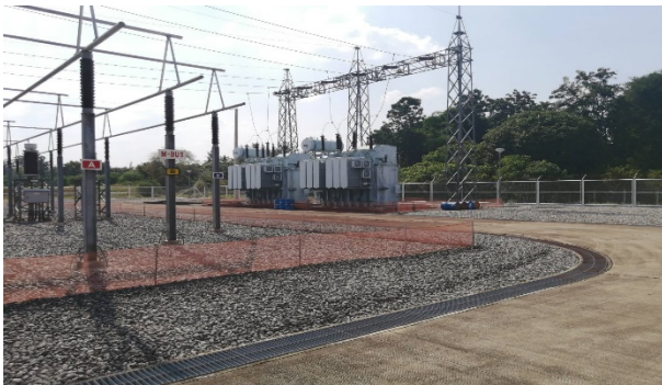
หม้อแปลงไฟฟ้า
