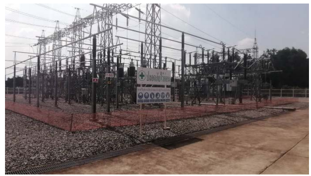
ลานไกไฟฟ้า 115 KV
