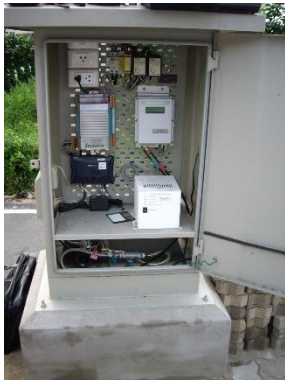
เครื่องวัดระบบ Master Meter และ Zone Meter พร้อมระบบรับส่งข้อมูลแบบ
