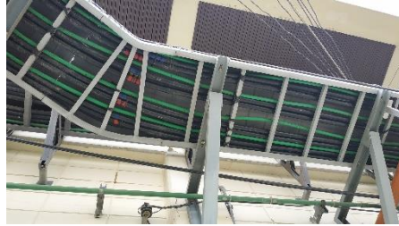
สายป้อนไฟฟ้า
