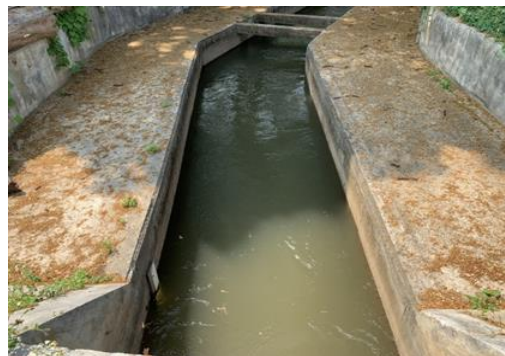
ระบบส่งน้ำ 3LMC จ.เชียงใหม่ (กรมชลประทาน)
