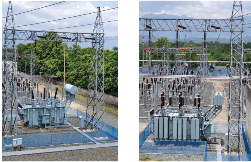
12.8 งานก่อสร้างสายส่งและสถานีไฟฟ้าแรงสูง 230/115 kV พะเยา
